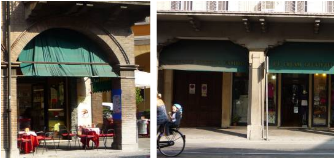
Due esempi di tende parasole che presentano elementi da sostituire in Via Beato Luca Belludi.
